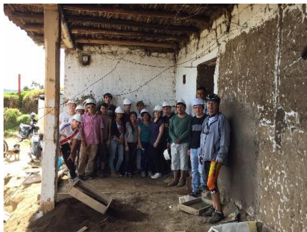
Figura 65. Intervención de edificación en tierra. Propietario: Alicia Uarrango. Lugar: Corregimiento de Obonuco – Municipio de Pasto. Fuente: Archivo Departamento de Arquitectura.
